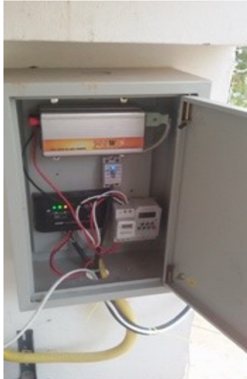
ภาพที่ 2 แสดงภาพเครื่องควบคุมระบบไฟฟ้าส่องสว่างทางเดินพลังงานแสงอาทิตย์
