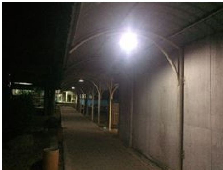
ภาพที่ 3 แสดงภาพโคมไฟฟ้าส่องสว่างทางเดินพลังงานแสงอาทิตย์
